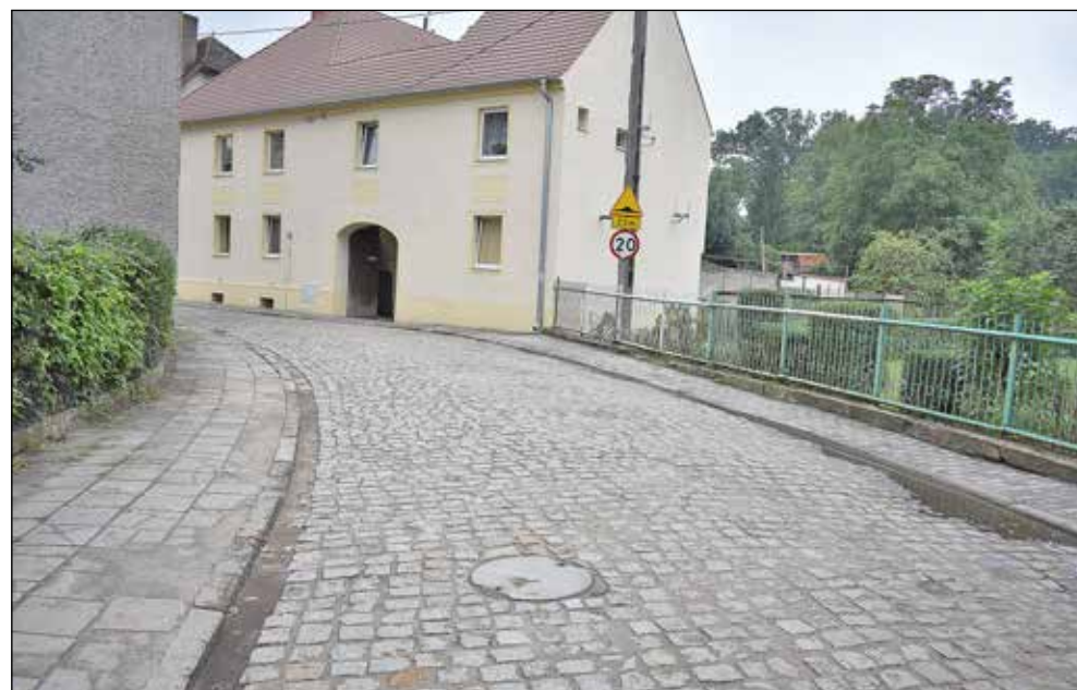
Ul. Zamkowa, wykonano 170 m kanalizacji z rur PCV o średnicy \phi 315 i 250 oraz 105 metrów sieci wodociągowej z rury PE o średnicy \phi 160. Nawierzchnia z kostki brukowej została odpowiednio odtworzona.
